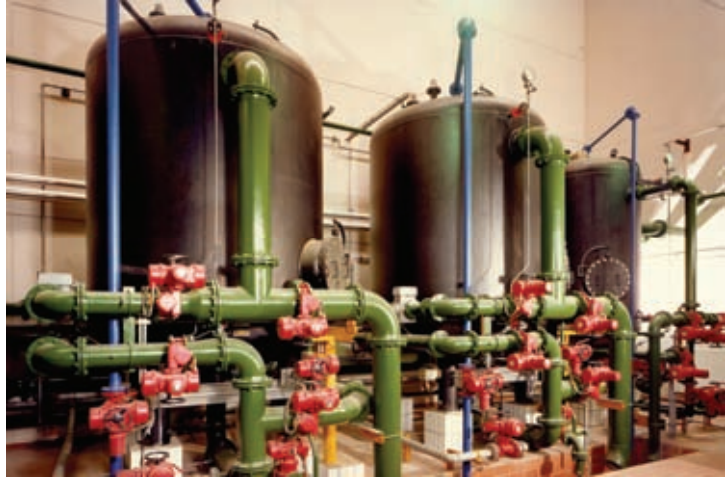
Kiesfilterstation der Betriebswasseraufbereitungsanlage
