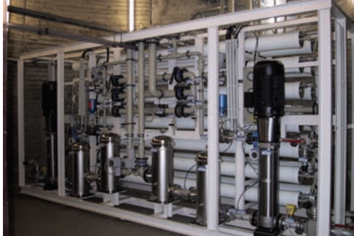
Ansicht der Umkehrosmoseanlage
