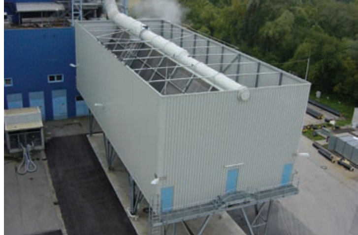
Luftkondensator nach Entnahme-Kondensationsturbine
