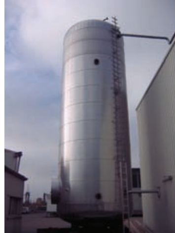
Schichtenspeicher der Frosta AG
