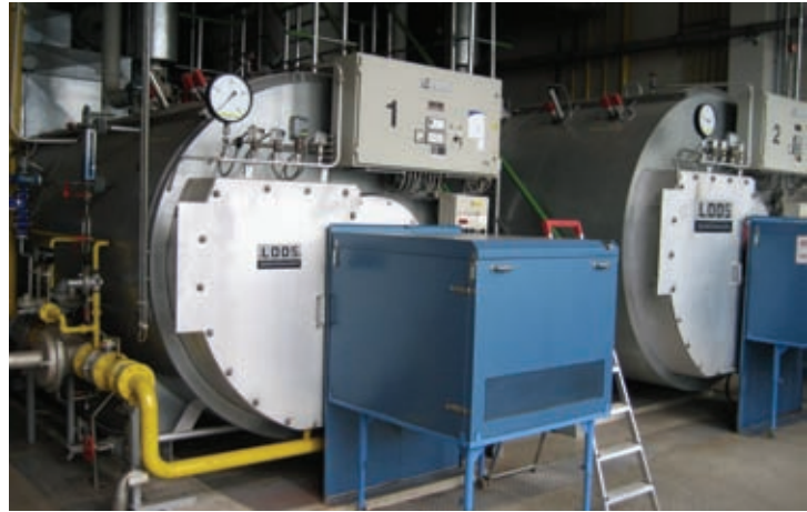
Kesselanlagen am Standort Bad Fallingbostal
