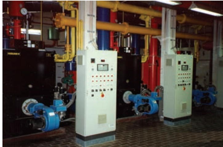
Bestehende Gaskesselanlage, Nutzleistung je 1.000 kW
