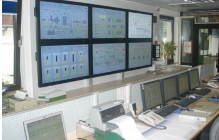
Schaltwarte Energiezentrale Maschinenhaus 2
