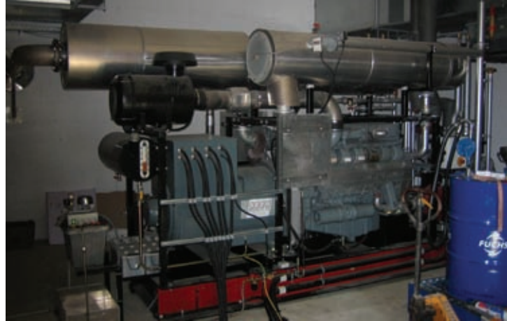
BHKW MAN 2842 LE202
