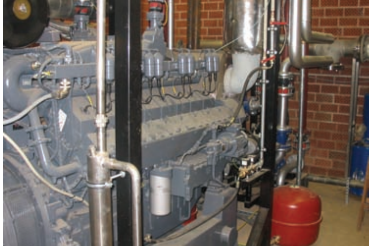
BHKW Deutz TCG 2016 B V16
