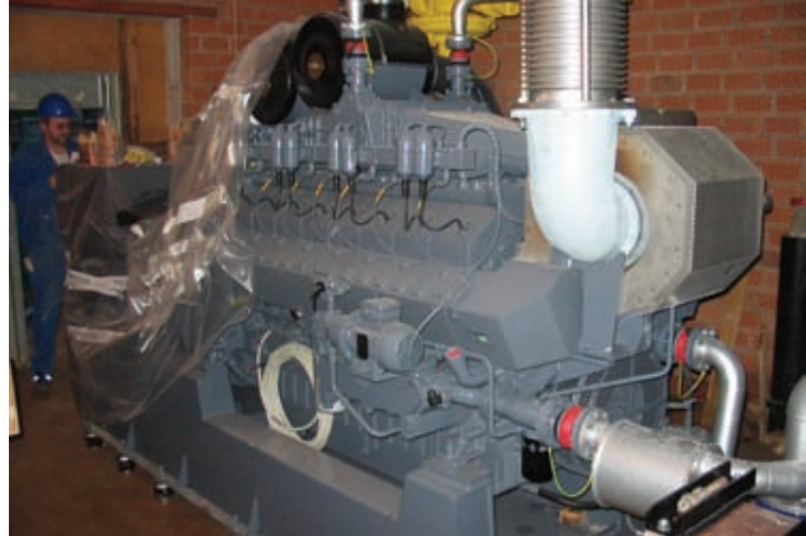
BHKW Deutz TCG 2016 B V16
