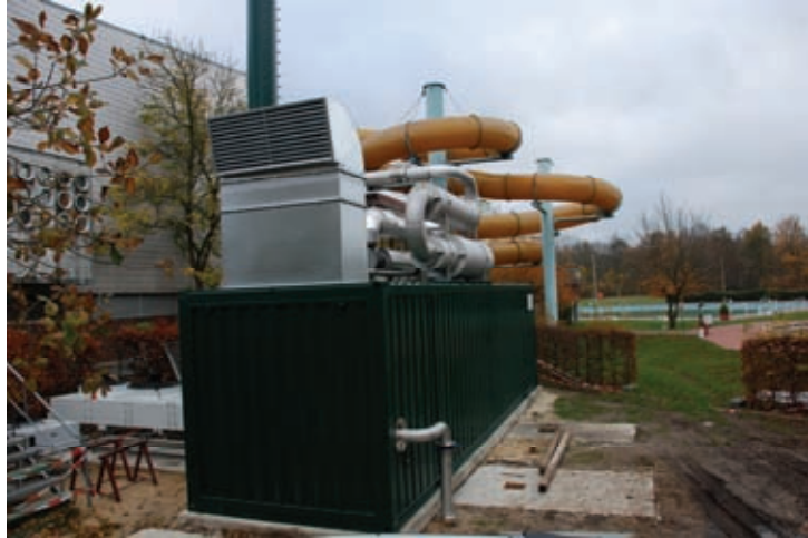
BHKW Schwimmbad Delfina
