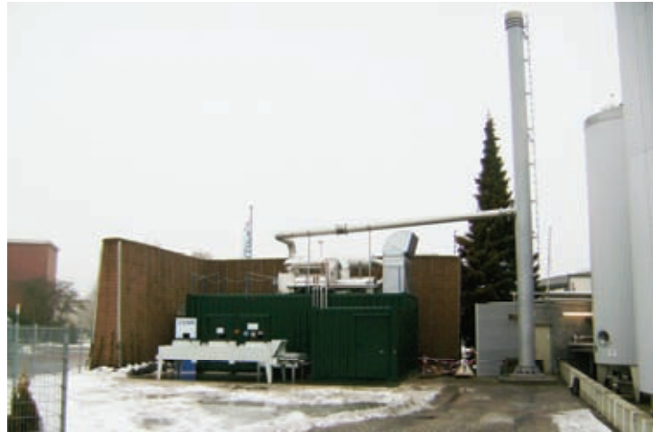
BHKW Werksgelände CSM
