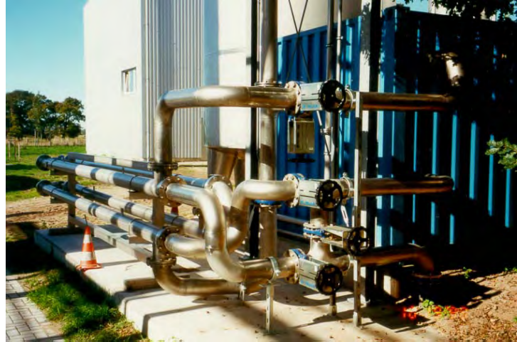
Wärmetauscher, Zwischenspeicher und Maschinenraum
