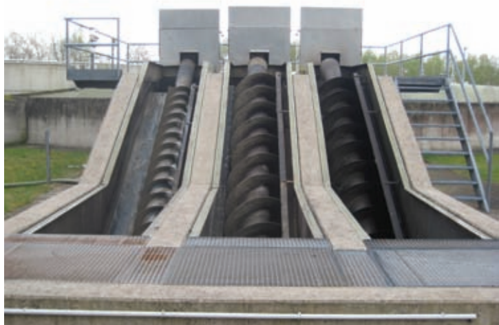
Kläranlage Schneverdingen, Schneckenpumpwerk
