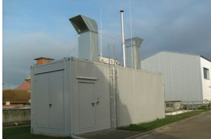
Blockheizkraftwerk auf der Kläranlage Heppenheim
