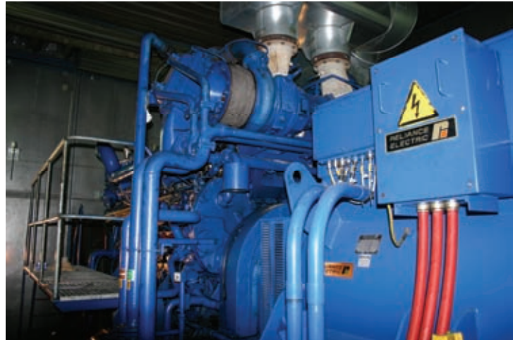
BHKW Deutz MWM
