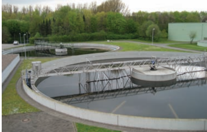
Kläranlage Bielefeld- Heepen
