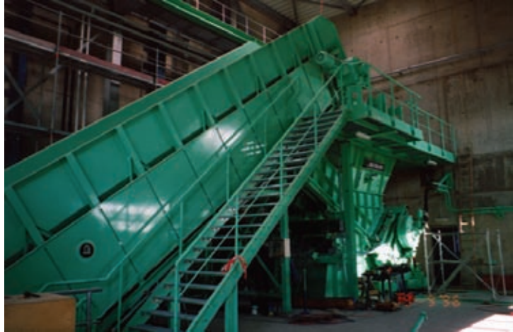
Transportband und Sperrmüllschere
