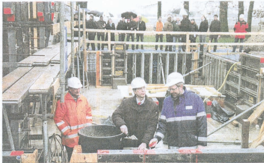
Stadtwerke-Geschäftsführer Hans-Ulrich Salmen (rechts) und Oberbürgermeister Patrick de La Lanne legten den Grundstein für die Erweiterung des Wasserwerks in Annenheide. FOTO: MÖLLERS
