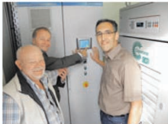
Jürgen Rahm, Bürgermeister Harald Behrens und Stefan Ehlers (v.l.) nehmen die Mikrogasturbine am Klärwerk in Betrieb. FOTO: RÜHL
