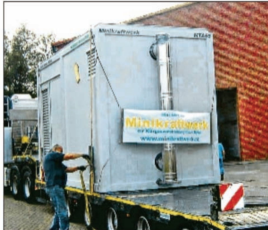
Minikraftwerk im Container auf der Kläranlage. • Foto: Stadt
